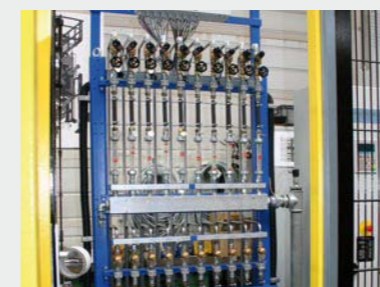
Kühlsysteme: Wasser-, Luft- oder Mischkühlung
